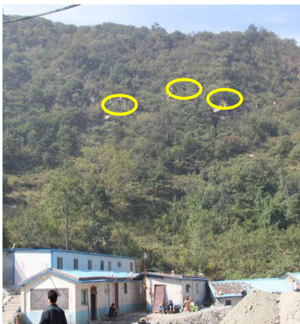
照片 3.2-2 BY2 崩塌隐患（镜向西北）
