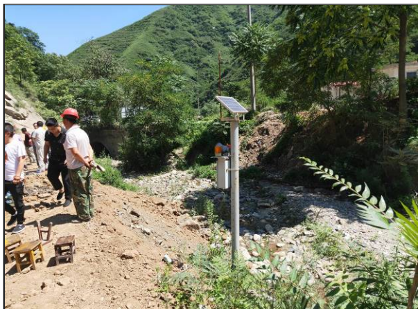
照片 2.6-9 泥石流监测仪 (镜向 70°)
