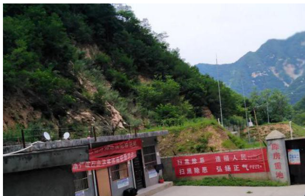
照片 3.2-1 BY1 崩塌隐患（镜向西北）
