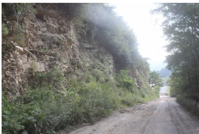
照片 3.2-5 B5 崩塌隐患点 (S)
