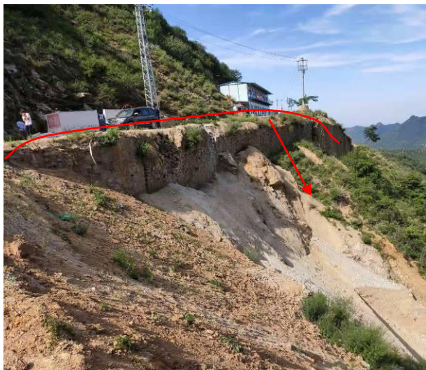
照片 3-2 B2 崩塌（镜向 140°）
