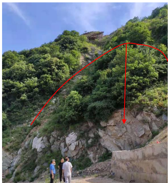
照片 3-1 B1 崩塌 (镜向 165°)
