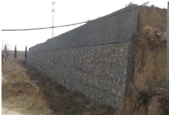
照片 2.6-1 工业场地崩塌隐患治理（镜像：NE）
