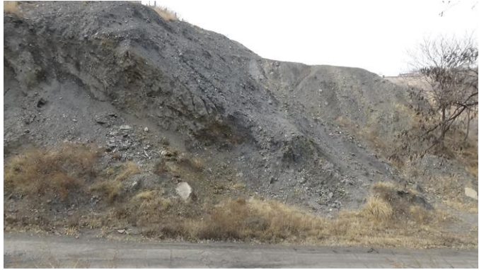
照片 3.2-4 原排矸场 2#不稳定边坡细节 (H2)
