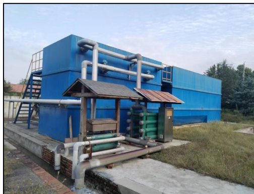
照片 1—4 污水处理设备
