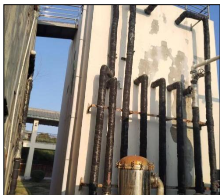
照片 1—3 地热井换热水塔
